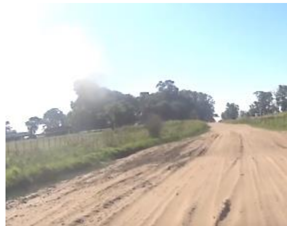
Imagen 7 – Huellones longitudinales por el paso de vehículo pesados. Km 2,5
