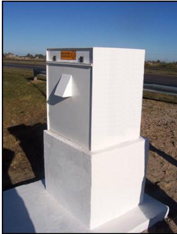
Base + gabinete (falta pantalla solar en la parte superior del gabinete)
