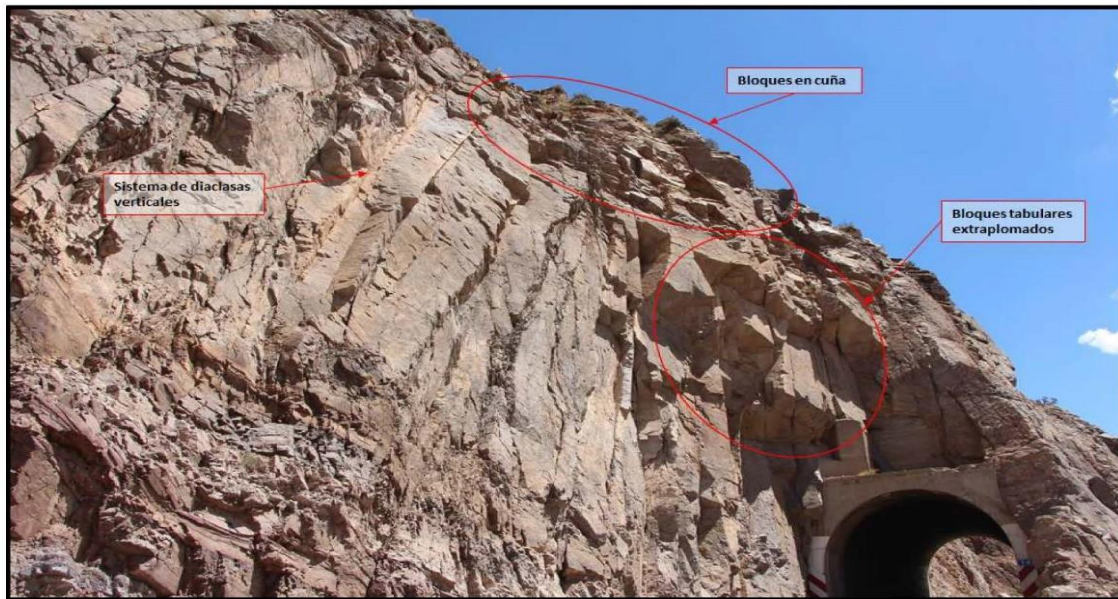
Figura 36: Vista del túnel 4 entrada donde se observa la problemática general de los sectores descritos en este ítem.
