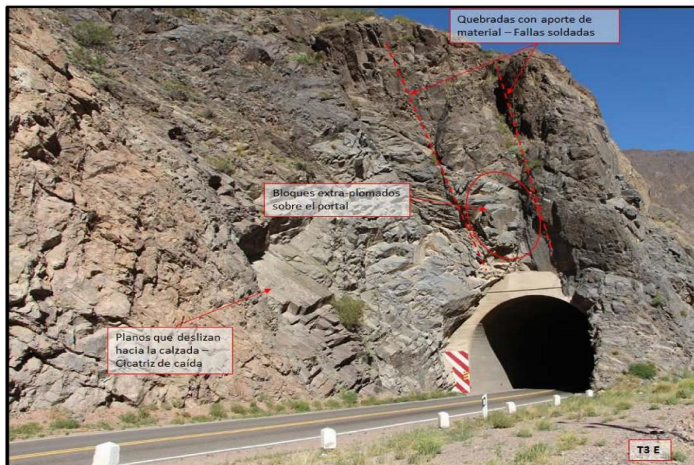
Figura 32: Problemática geológica en el portal entrada del túnel 3.
