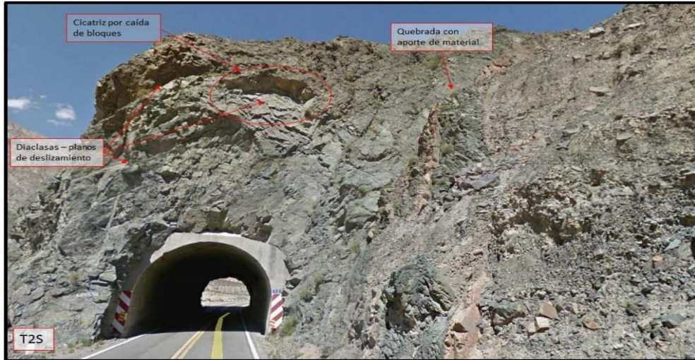
Figura 30: Problemática geológica en el portal salida del túnel 2.
