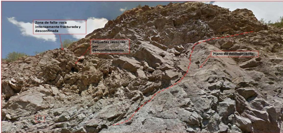
Figura 8: Problemática geológica del contratalud P5.
