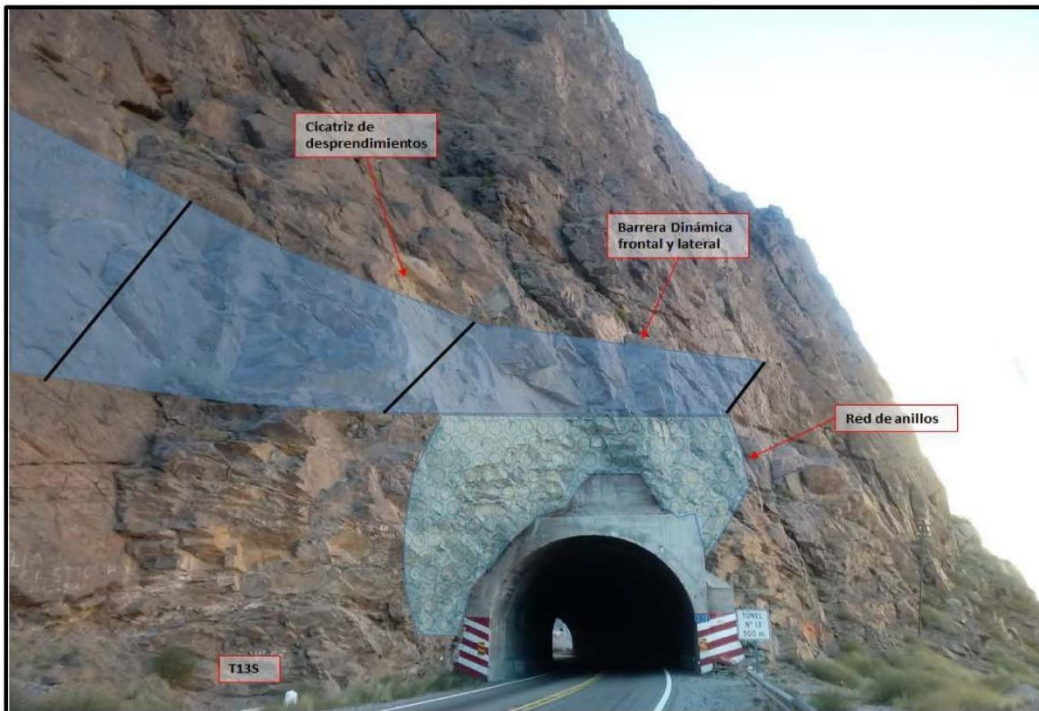
Figura 63: Esquema de protección de laderas propuesto para el portal salida del túnel 13.
