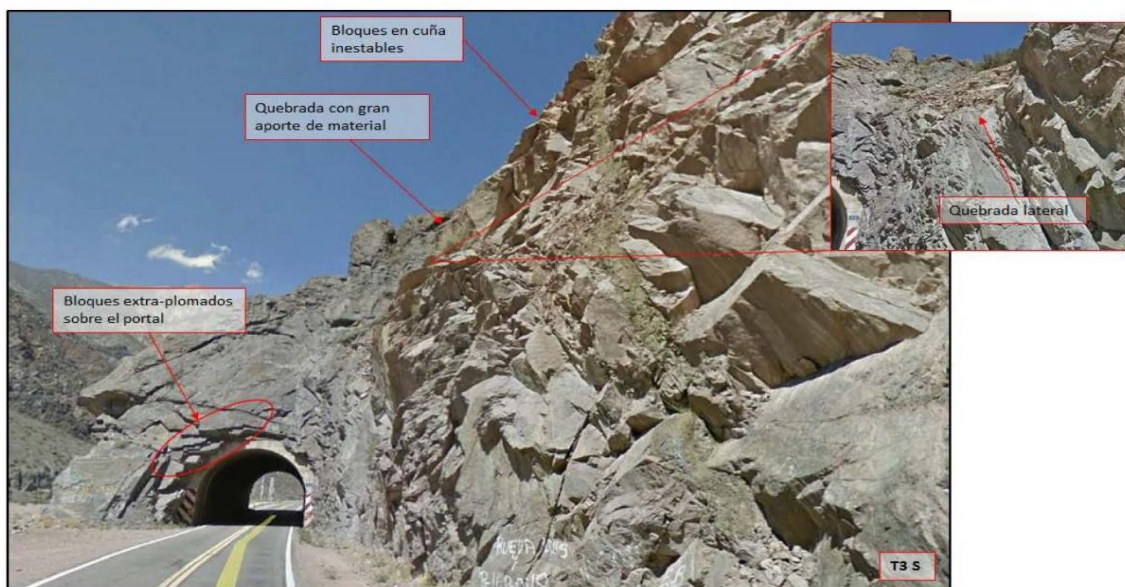
Figura 34: Problemática geológica en el portal salida del túnel 3.
