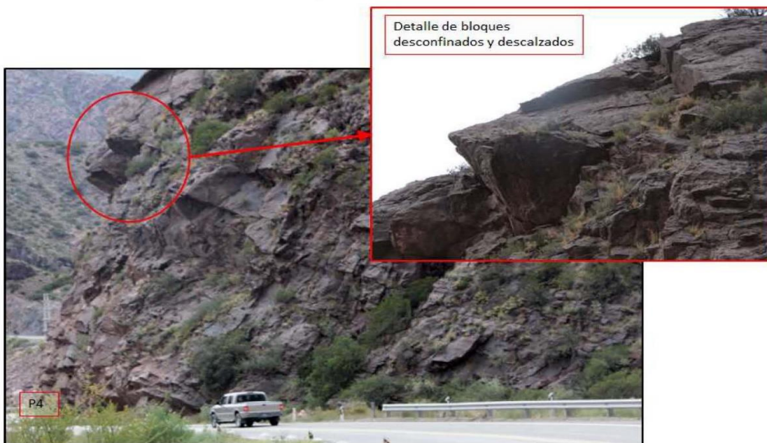
Figura 7: Problemática geológica del contratalud P4.
