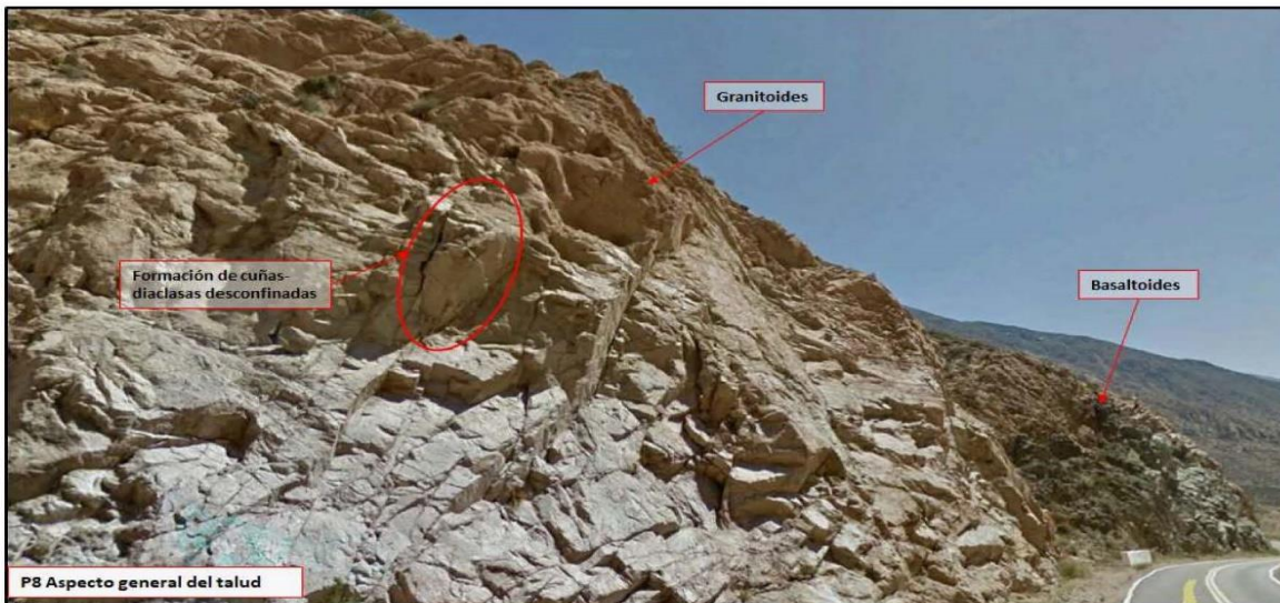
Figura 21: Problemática geológica en el contratalud P8.
