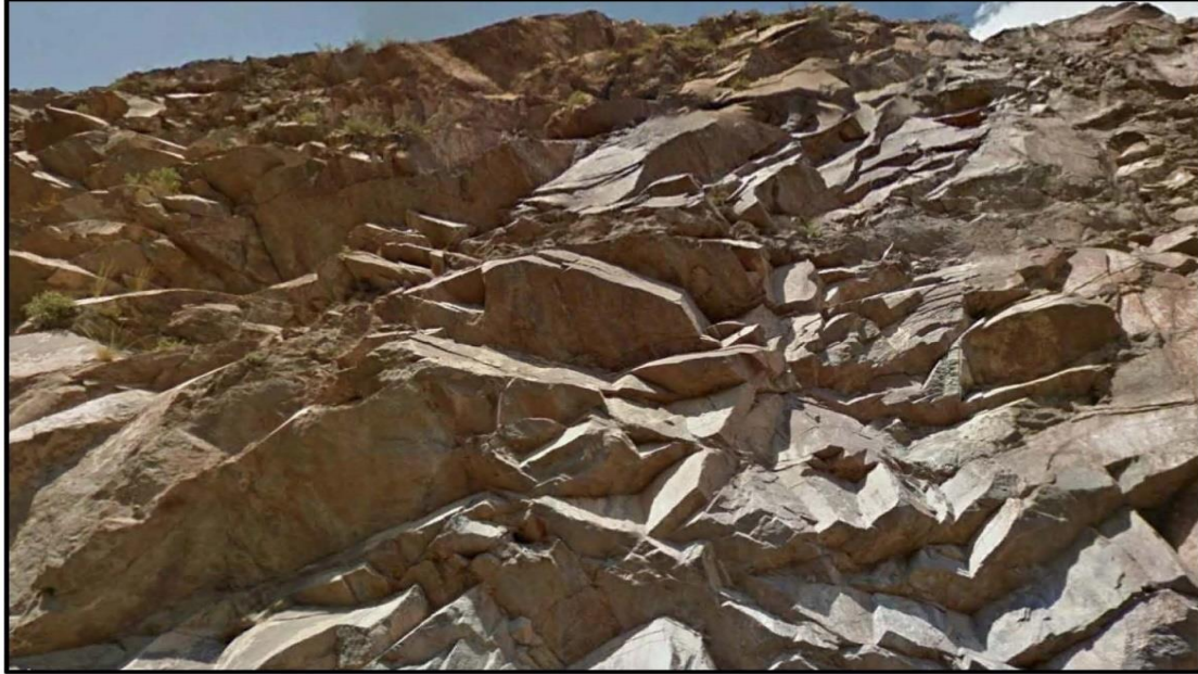
Figura 5: Vista general del sector superior del contratalud, tomada desde la calzada, donde se observa la gran formación de cuñas inestables.
