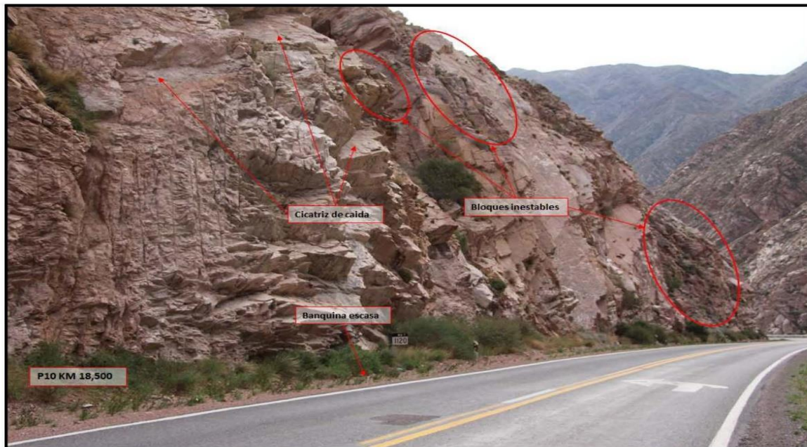
Figura 24: Problemática geológica en el contratalud P10.
